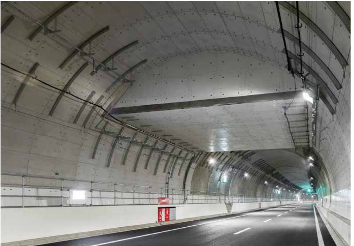
山手トンネル・品川線 トンネライト
