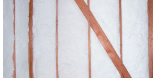
アクリアウル施工例 ※別途防湿シートを施工してください。
