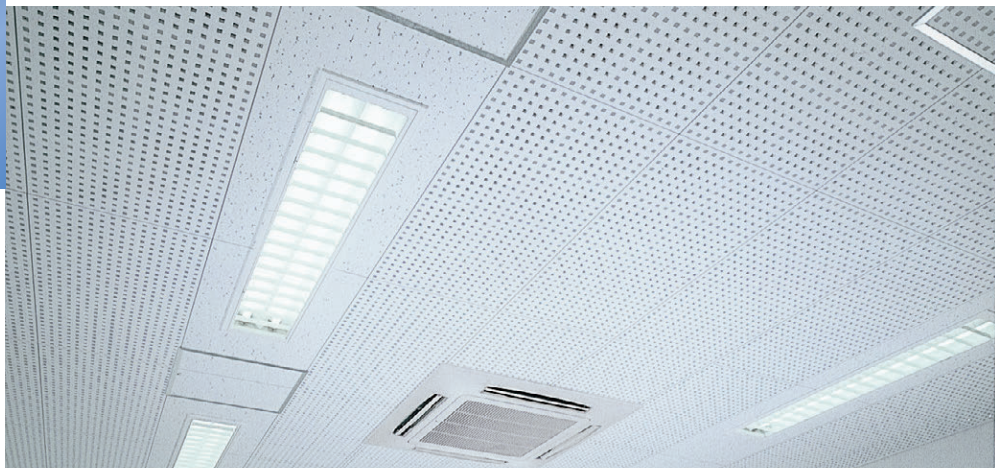
「タイガースクエアートン・Dプラス」と「ジブトーン・ライト」を組み合わせる施工した会議室の天井
